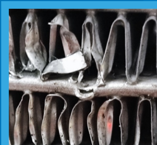
8. Zbliżenie na miejsce uszkodzenia
